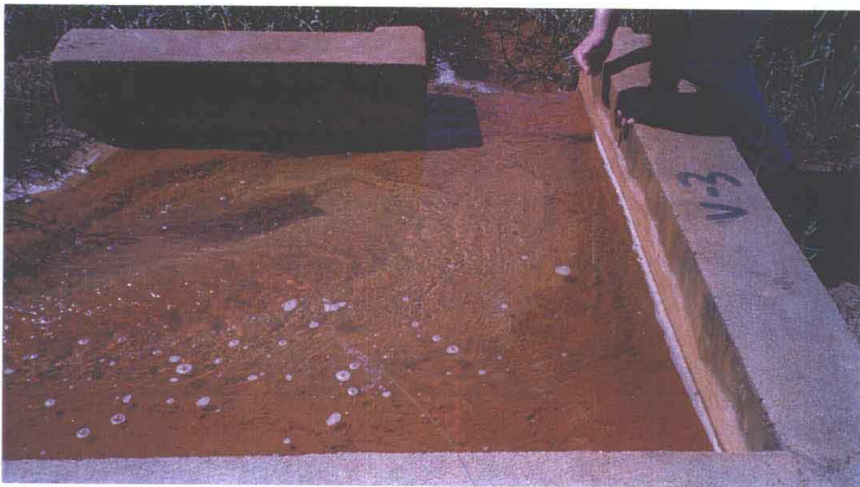
Foto 10 - Pormenor do medidor de vazões V3.
