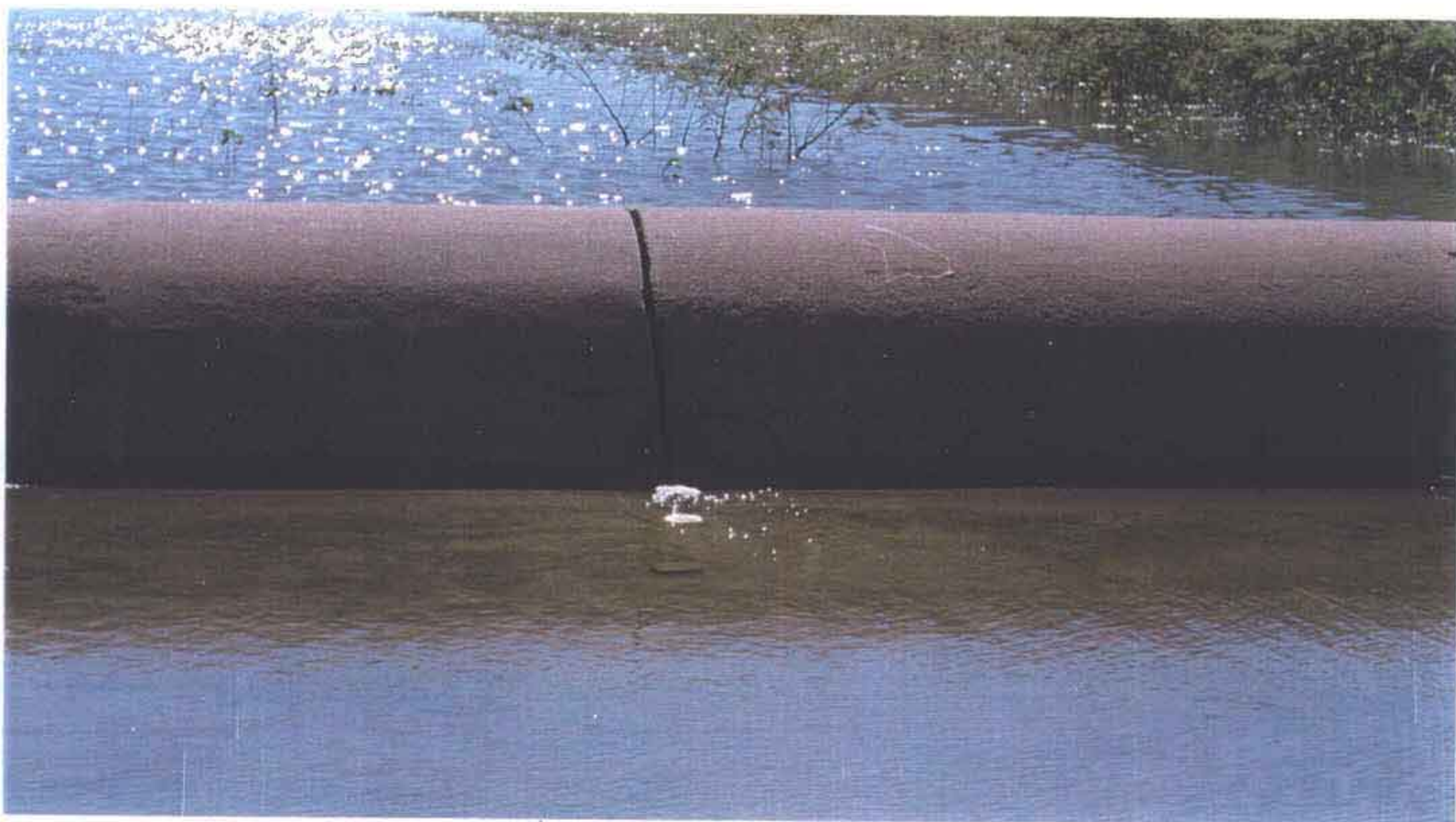
Foto 6 - Pormenor da soleira de controlo do vertedouro. Visível a passagem de água por uma das juntas.
